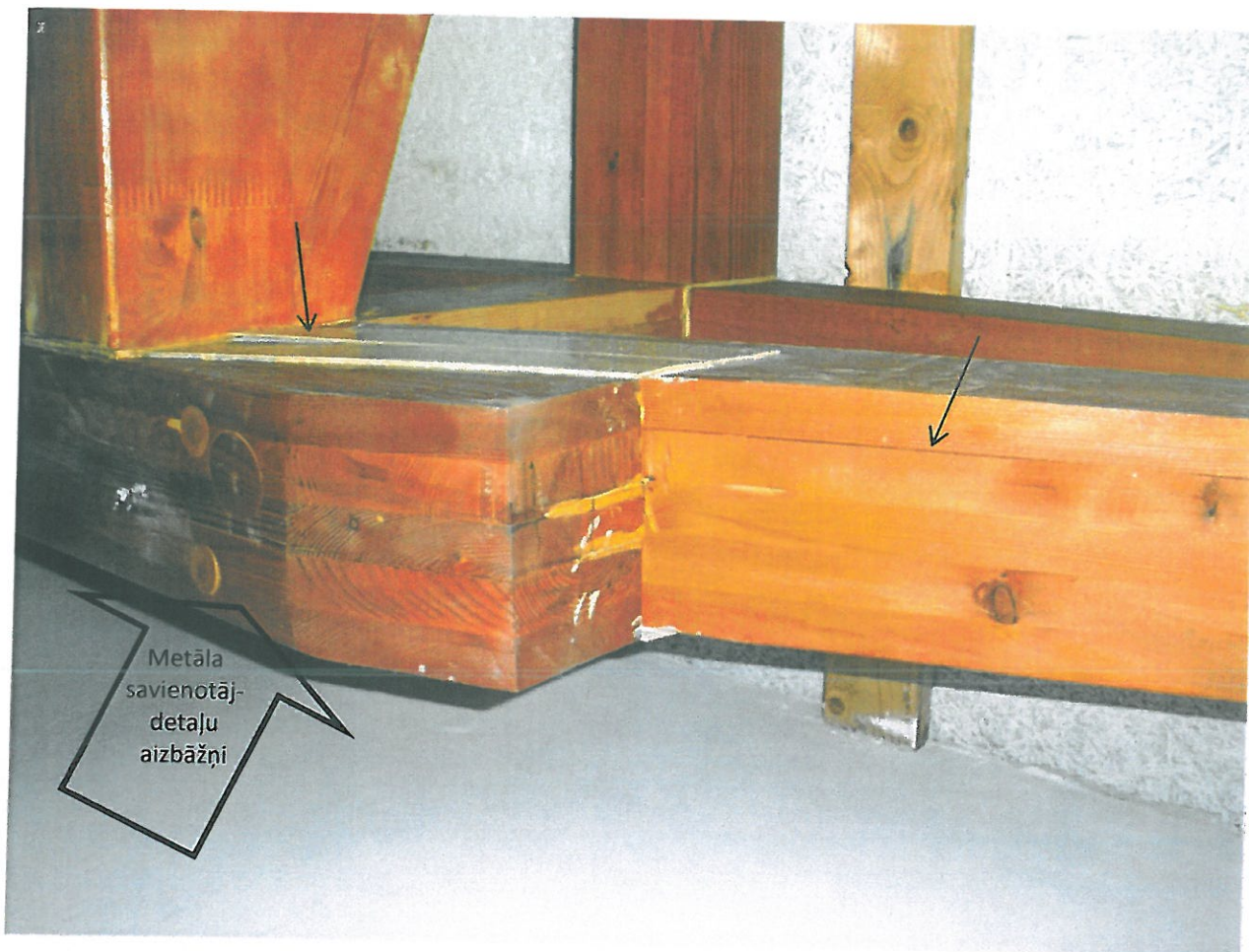
8. attēls. Līmēto elementu atslāņošanās. Redzamas kopņu elementu slēpto metāla savienotājdetaļu aizbāžņu vietas.
