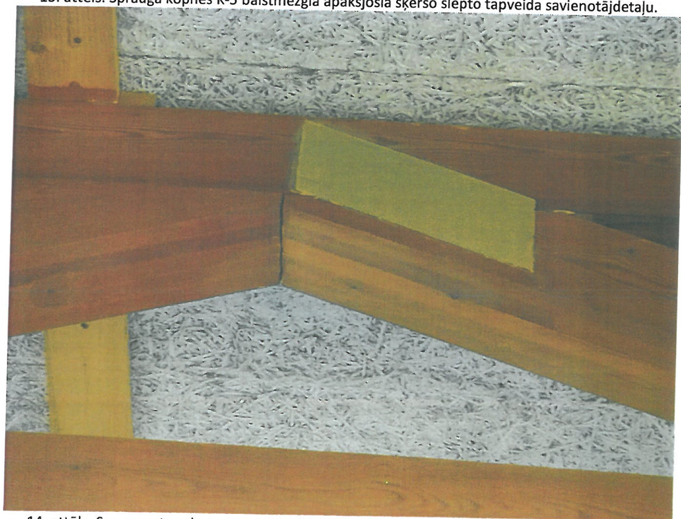
14. attēls. Sprauga starp kopnes K-5 atgāžņiem.
