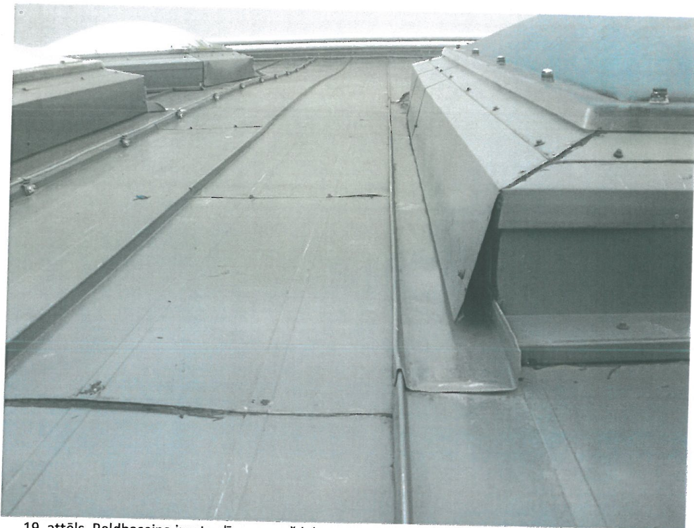
19. attēls. Peldbaseina jumta slīpnes augšdaļas turpinājuma fragments. Redzams jumta ieliekums.
