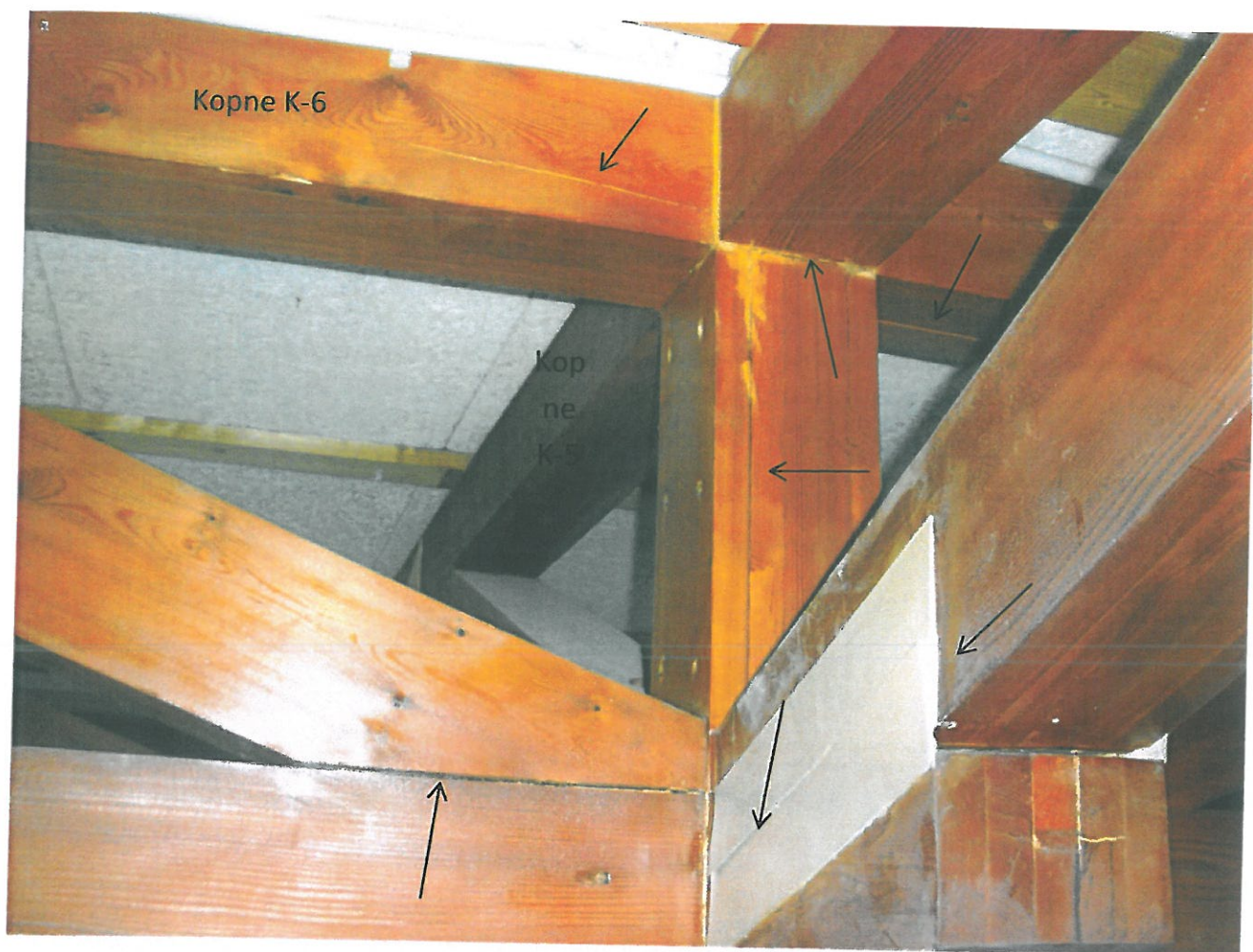
6. attēls. Vairākās vietās redzamas līmēto kopņu elementu atslāņošanās.
