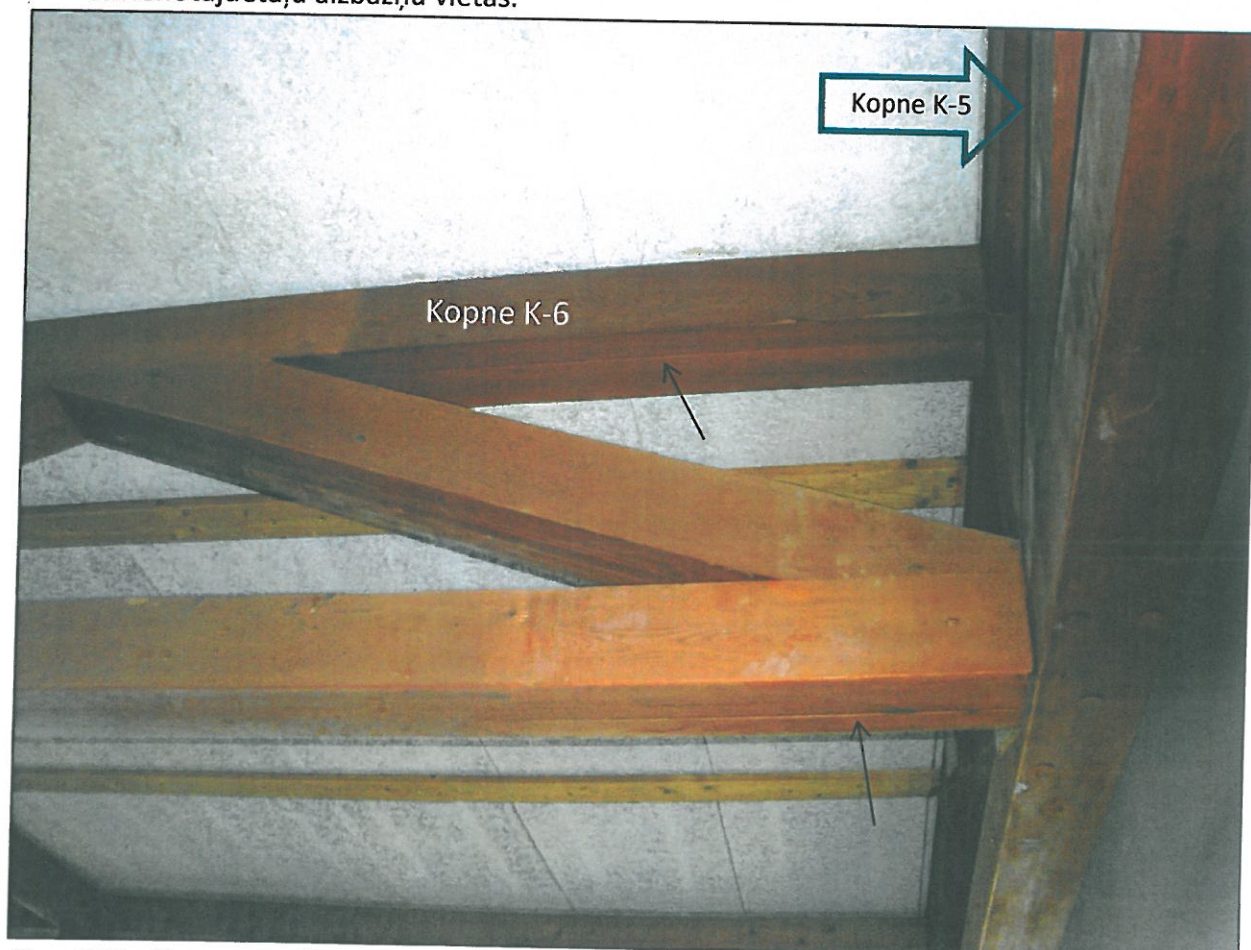
9. attēls. Kopnes K-6 līmēto elementu atslāņošanās. Redzamas kopnes KP-5 elementu slēpto metāla savienotājdetaļu aizbāžņu vietas.
